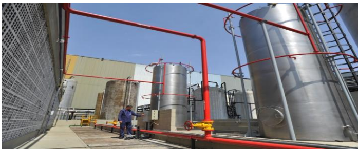
Tanques de estocagem de etanol
